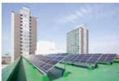
津田沼キャンパス4号館屋上 太陽光発電設備
