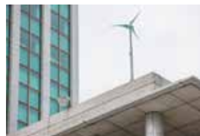
津田沼キャンパス6号館屋上 風力発電設備
