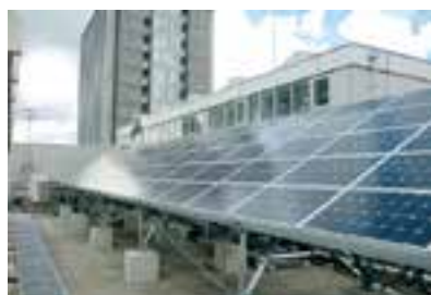
津田沼キャンパス7号館屋上 太陽光発電設備
