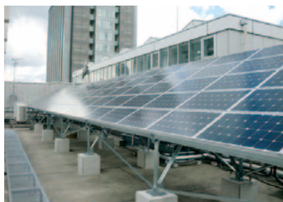
7号館屋上の太陽光発電設備
