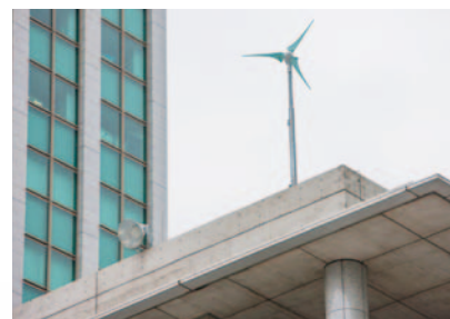
6号館屋上の風力発電設備
