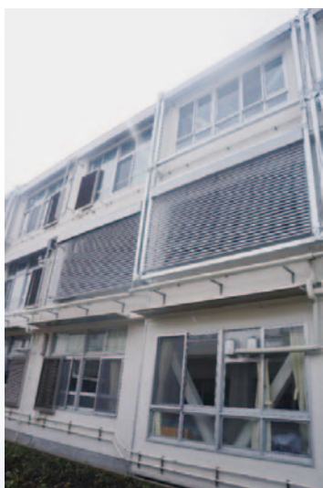
写真2 川崎市立学校施設再生整備事業モデル校に設置した外付けブラインド
