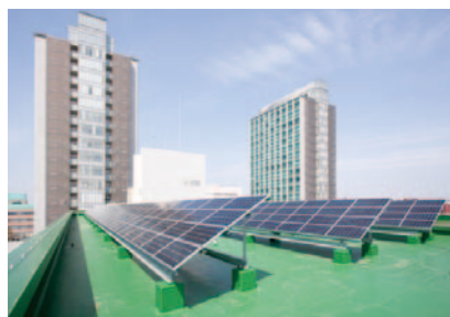
4号館屋上の太陽光発電設備
