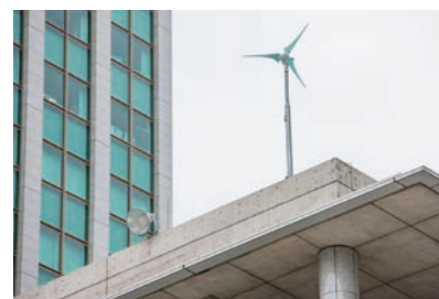
6号館屋上の風力発電設備
