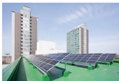
4号館屋上の太陽光発電設備
