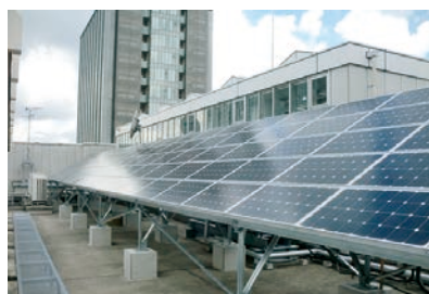
7号館屋上の太陽光発電設備
