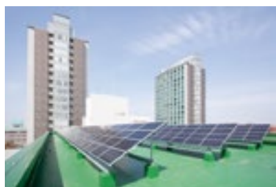
4号館屋上の太陽光発電設備
