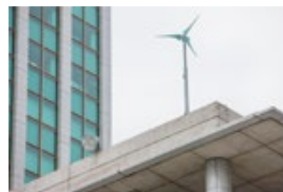
6号館屋上の風力発電設備
