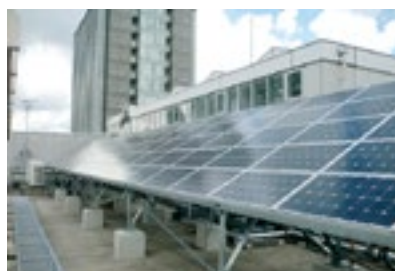
7号館屋上の太陽光発電設備
