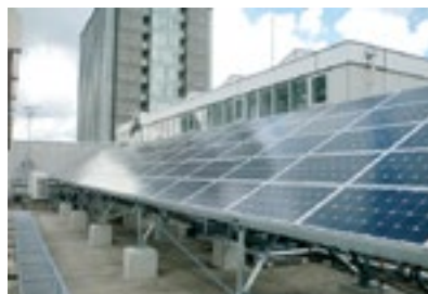
7号館屋上の太陽光発電設備
