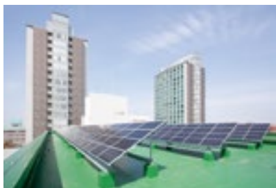
4号館屋上の太陽光発電設備
